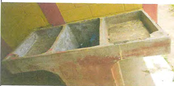
Foto 3: Pila en mal estado.
