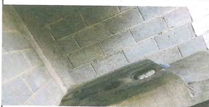
Foto 1: Estufa Rural en mal estado.
