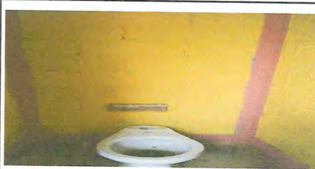
Foto 2: Sanitarios en mal estado.
