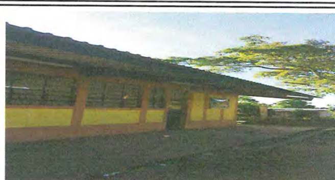
Foto 2: Pintura de escuela deteriorada.
