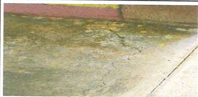
Foto 5: Piso en mal estado en las aulas.
